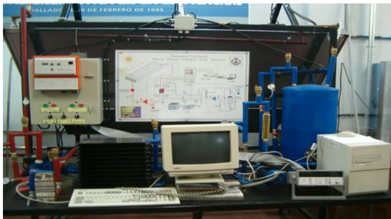
Instalación de energía solar térmica. Tecnologías
