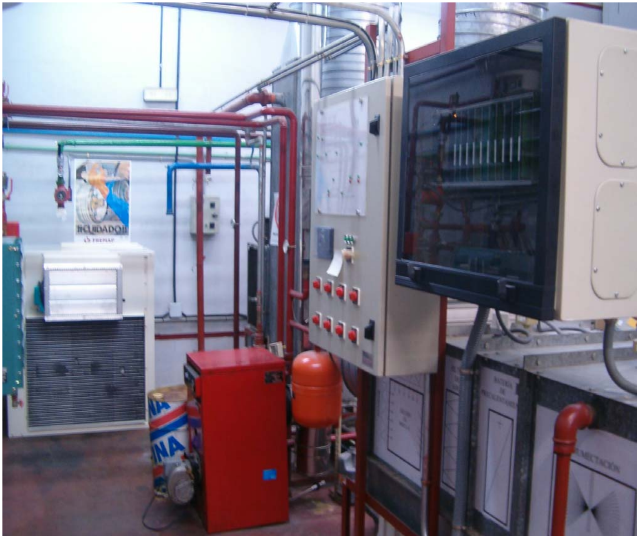
Instalación de calefacción, refrigeración y acondicionamiento de aire. Descripción de equipos. Monitorización. Regulación y Control
